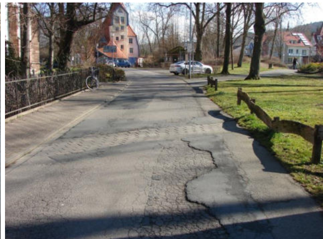
Schlechter Zustand mittlerer Teile der oberen Straße Quelle: eigene Aufnahme
