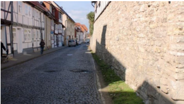
Schäden und Nutzungseinschränkungen: Mauerstraße Quelle: eigene Aufnahme
